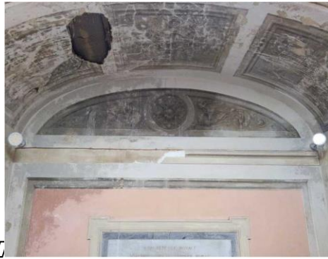
Parte del soffitto é crollato
