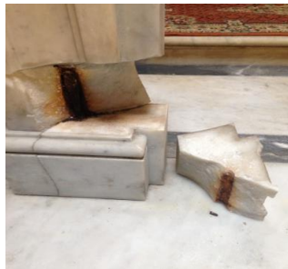
La balastrata rotta
