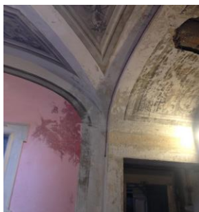
I danni causati da umidità
